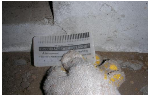
■基礎ひび割れの確認 0.3ミリ程度以上の構造クラックが生じている場合は「ひび割れあり」と評価する
