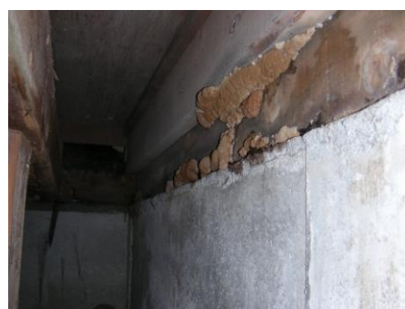
■浴室土台腐朽の様子
