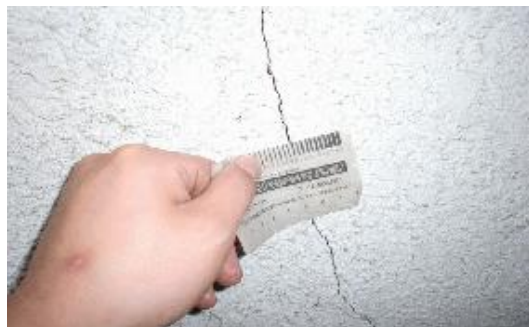
■外壁ひび割れ幅の確認
