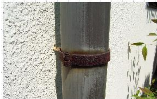
■縦樋の劣化(金具の錆)外れる恐れ有り
