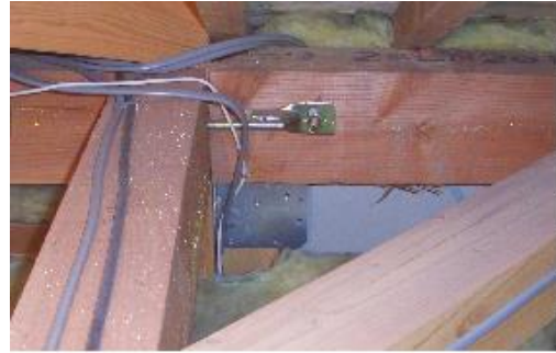
■横架材接合金物(羽子板ボルト)
