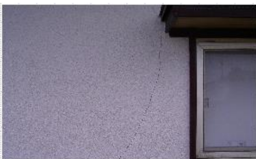
■外壁のひび割れ
