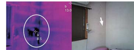
▲洋室出隅の断熱不良箇所：外気の冷気で低温
