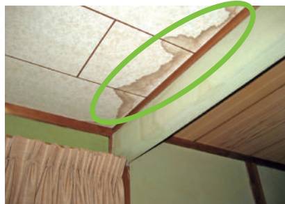
雨漏りによる天井の水染み例。下屋との取り合いや増築時の継ぎ目等に多く見受けられる
