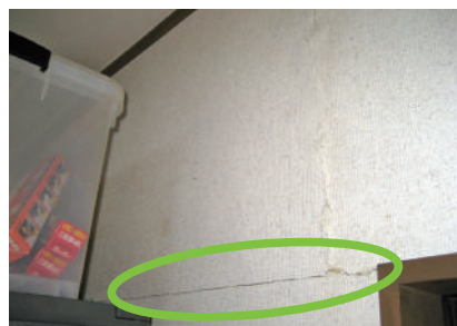
壁紙の亀裂の様子。明らかに下地材が動いている。 ※数カ所あることを確認する
