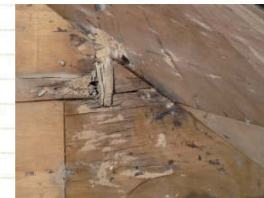
雨漏れヶ所下地野地板状況
