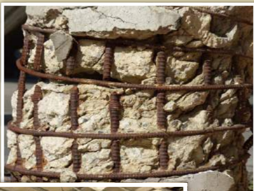
▲鉄筋がもき出しになった柱(大川小学校)
