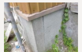
基礎のひび割れ
