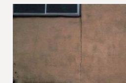
外壁のひび割れ・こけ
