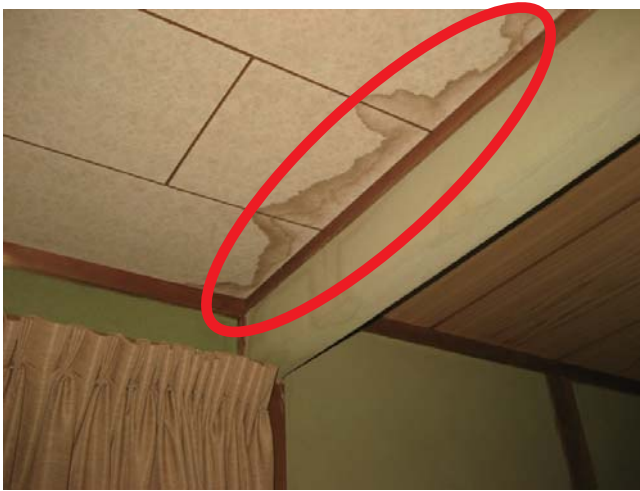
雨漏りによる天井の水染み例。下屋との取り合いや増築時の継ぎ目等に多く見受けられる。
