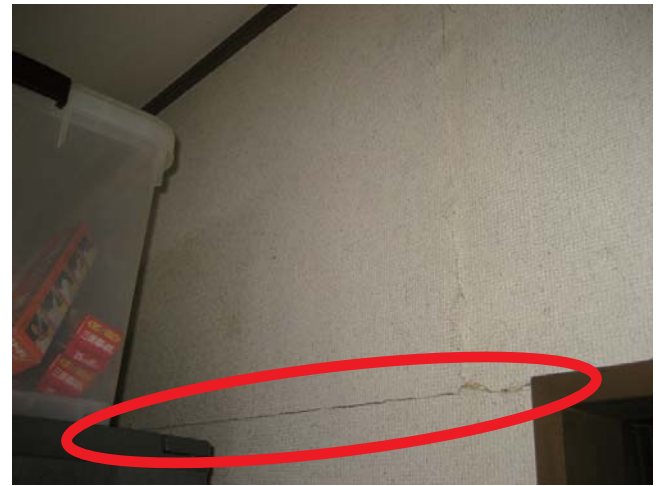
壁紙の亀裂の様子。明らかに下地材が動いている。 ※数カ所あることを確認する
