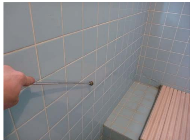
浴室タイルのひび割れや浮きの調査。打音検査棒を用いる。
