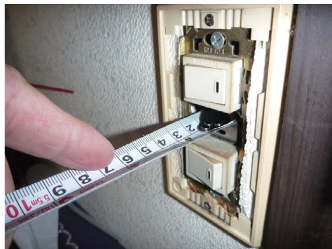
写真②：壁の仕様(素材や厚さ)の確認時にスイッチプレートのカバーを外したところ。
