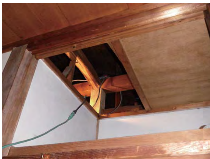
写真①：押入れや収納の天井部にある点検口から進入する。
