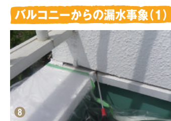
8 バルコニーからの漏水事象(1) バルコニーの床と建物本体の壁との取り合いに生じた隙間(防水不備)から雨水が浸入。放水試験を行い、屋内側への影響を確認。
