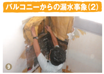
9 バルコニーからの漏水事象(2) 大きな水シミが出来ていた1階の天井に近い部分(吹き抜け)の壁から、放水した水が噴出。躯体の劣化、断熱材(グラスウール)の機能低下を招いている。
