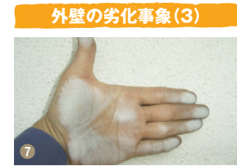
7 外壁の劣化事象(3) モルタル壁であっても、サイディング材であっても、表面の塗膜の劣化は、手でなぞってみれば一目瞭然である。白い粉が付着すれば、塗替えの時期である。
