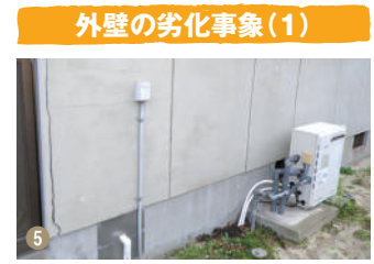
5 外壁の劣化事象(1) 外壁のひび割れは、放置しておくと、モルタル下地のラス網が錆びて、外壁全体の浮きにつながることも。
