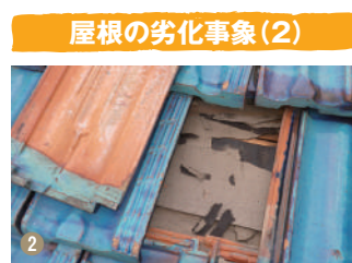
2 屋根の劣化事象(2) 屋根材そのものは健全でも、下側の防水層(ルーフィング)がボロボロでは、雨漏りし放題である。防水紙の張替えが必要である。
