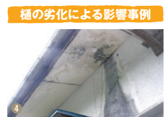
4 樋の劣化による影響事例 縦樋に砂埃や枯葉が溜まり、劣化した上、雨のたびに雨水が噴出し、屋根下地だけではなく、軒天材や外壁が劣化している。
