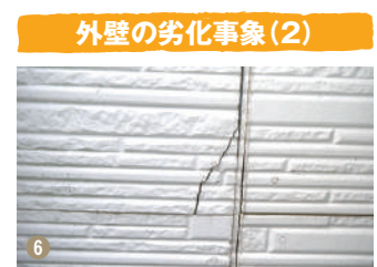
6 外壁の劣化事象(2) 窯業系サイディングのジョイント部のシーリングの劣化(亀裂)や、サイディングそのものの亀裂は壁内部への浸水、断熱材の腐食や機能低下にもつながることも。
