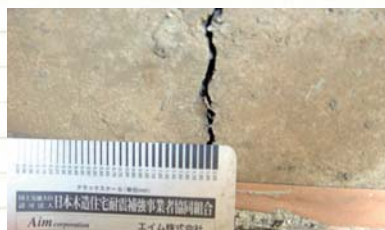
基礎の劣化サンプル
