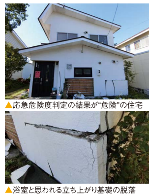
▲浴室と思われる立ち上がり基礎の脱落
