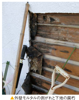
▲外壁モルタルの剥がれと下地の腐朽
