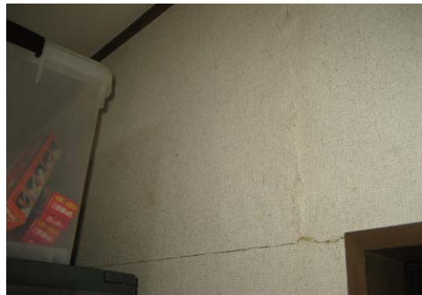
【写真③】明らかに下地材が動いている壁紙の亀裂の様子。 ※数カ所あることを確認する
