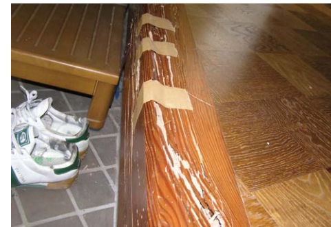
【写真⑤】玄関扉の白アリ被害の様子
