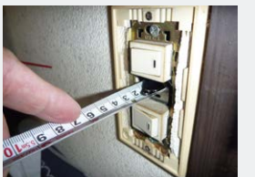
【写真②】壁の仕様(素材や厚さ)を確認するためにスイッチプレートのカバーを外したところ
