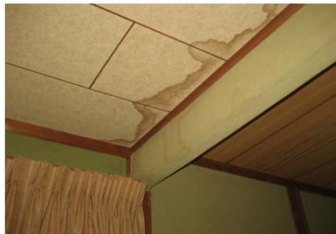
【写真④】雨漏りにより天井に発生した水染み。下屋との取り合いや増築時の継ぎ目等に多く見受けられる
