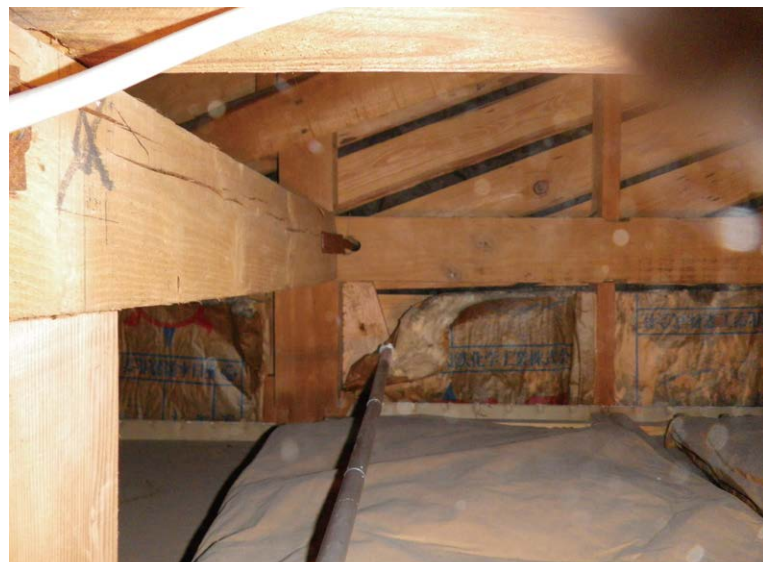
【写真④】小屋裏で伸縮棒を使い断熱材をはがしているところ。伸縮棒は手の届かない場所の筋かいを確認するために重宝する
