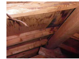
【写真①】雨水が小屋裏へ浸入しているケース
