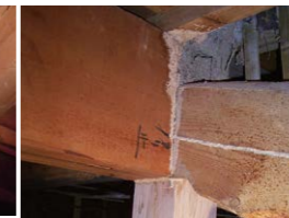
【写真②】柱から梁にかけて白っぽく見えるのが蟻道
