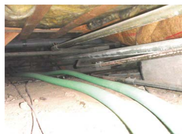
【写真⑥】床下には様々な配管や配線があり、進入の妨げになることもある
