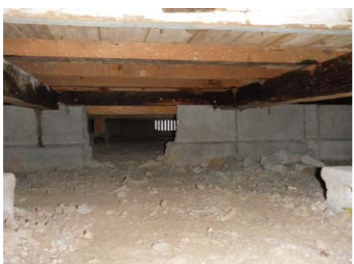
【写真⑦】コンクリートブロック基礎の住宅 ※4
