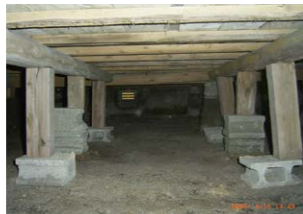
▲床の荷重を支え、床の水平を保つべき束石がコンクリートブロックになってしまっている
