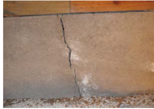
▲一般部(布部)のひび割れは、換気口部に発生するひび割れよりも更に注意深く確認する必要がある。地盤の影響や、地震や台風力による建物の変形による建物の変形も考えられる
