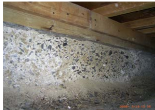
▲コンクリートの風化は、雨水や空気中の炭酸ガスが作用を受け、酸化することで起こる。強度が低下し、内部の鉄筋をさびやすくする
