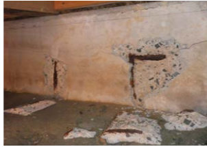
▲鉄筋のかぶり厚さが不足しているため、内部の鉄筋が湿気で酸化・膨張し表面のモルタルを押し出している
