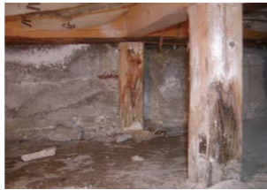
▲束の風化。湿気の多い床下では束の腐食も進んでいることが多い
