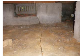
▲基礎部分に、地割れの影響を受けひび割れが入っている状態。造成地で盛土をした部分の沈下や地震の影響が考えられる
