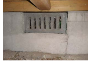
▲多くの建物で見られる、換気口周りのひび割れ現象。建物全体におよびひび割れなのか、一部のみのものか、注意深く観察し劣化度の判定を行う
