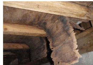
▲下地材の劣化。湿気の多い床下は、根太や下地材の腐朽も床の劣化事象(きしみや沈み)の要因ともなる
