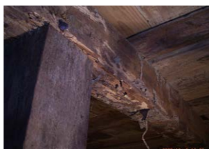
▲白アリによる被害は多岐にわたるが、束から土台や大引き、さらには根太や下地材までも蝕んでいく。柱(柱脚)から天井裏へ害が及ぶこともある
