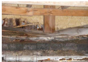
▲土台が完全に腐り、その上の柱が沈下している状態。大掛かりな補修や補強が必要となる
