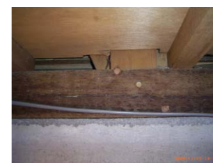
▲柱の位置の確認:柱の両側には筋かいも見えない。また防蟻工事の後も確認できる
