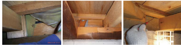
▲断熱材(グラスウール)をめくって、筋かいの位置を確認。筋かいのサイズ(幅と厚み)の確認も忘れずに ▲柱や土台との接合方法(釘打ち、プレート金物)も確認する ▲際(きわ)根太や根太掛けなどで確認しづらい場合、細いドライバーなどを差し込み、筋かいの有無を確認する※1
