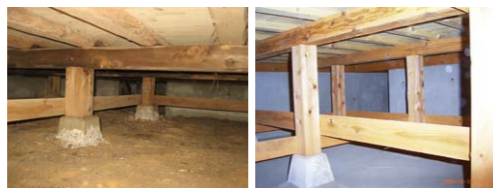
▲布基礎:湿気が多く、シロアリによる被害も多い。ただし、換気口が機能し、床下の換気が十分だと木材の腐朽や蟻害も抑えることができる ▲ベタ基礎:湿気が低く、シロアリの被害も少ない。ただし、換気口がしっかり機能しなければ、湿気がこもりやすくなる
