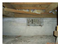
▲写真は、床下換気口がホコリで塞がっている例。定期的に掃除をする必要がある
