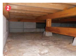
②全体がコンクリート基礎であっても、部分的にコンクリートブロックの基礎である場合もある。写真は増築部がコンクリートブロックの基礎となっている例
