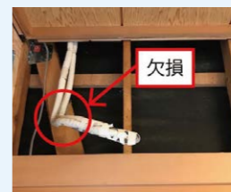
▲欠損のある筋かい
