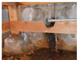
【写真⑧】 従来（タイル張り）の浴室と洗面脱衣室の境界の基礎（配管貫通部）から、浴室床下にしみ込んだ水が漏れ出ている。長い年月を経て、床下は染み出た水で、水溜りができている
