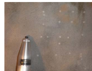
【写真⑥】 測定は、数箇所行い、その平均値を採用する。写真で白く見える点が、測定した箇所
