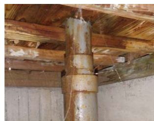
【写真⑨】 トイレの排水管の接合部に亀裂が発生し、床下に汚水が溜まった状況。悪臭のみならず、床板や下地材などが腐食している。放置しておくと、大掛かりな補修が必要になる
