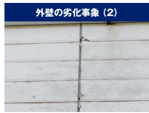
▲窯業系サイディングのジョイント部のシーリングや、サイディングの亀裂は、壁内部への浸水や断熱材の腐食、機能低下につながる
