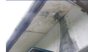
◀縦樋に砂埃や枯葉が溜まり劣化した上、雨のたびに雨水が噴出し、屋根下地だけではなく、軒天材や外壁も劣化している
