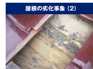
▲屋根材は健全でも下側の防水層（ルーフィング）がボロボロでは雨漏りするため、防水紙の張替えが必要
