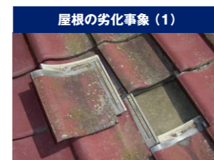
▲セメント製の瓦は、表面の塗装が劣化し、雨水の浸み込みによる割れや苔などの発生事象が見受けられる
