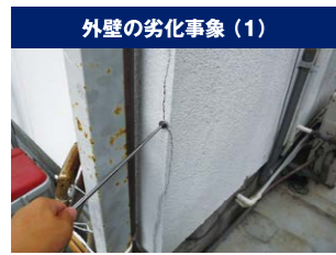
▲外壁のひび割れは放置すると、モルタル下地のラス網が錆び、外壁全体の浮きにつながることもある
