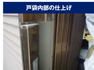
◀それぞれの壁の持つ強さ（壁強さ倍率）は、壁の表裏の材料と軸材（筋かいや土塗り壁）で決まる。戸袋の内側＝外壁側の材料の確認を忘れずに。「外壁はモルタルで、戸袋内部はベニヤ」ということも多い
