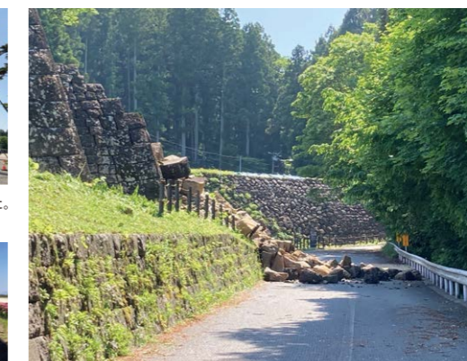
▲本丸北西の石垣は今年3月の地震で崩壊し、復旧には3年かかるそう。手前の石垣は、隙間なく敷き詰められた切込ハギで、奥が野面積み。残っている事が野面積みの強さを物語る。
