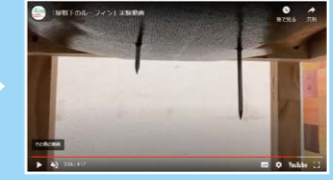
はたして、水漏れはあるか…?!
