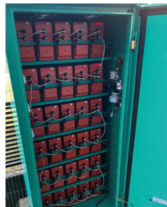
▲大容量の蓄電池で安定した電源を供給
