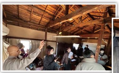
▲研修所の2階は天井を解体し、金物や筋かいが見やすくなっています
