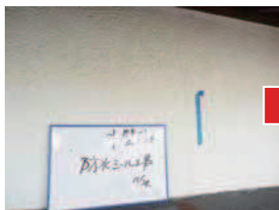
外壁のひび割れ
