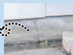
基礎のひび割れ
