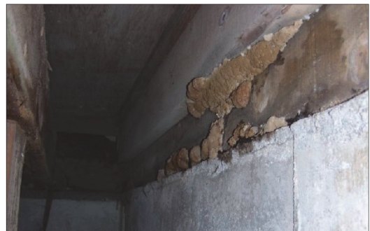
浴室土台腐朽の様子
