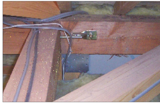
横架材接合金物（羽子板ボルト）
