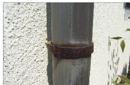
縦樋の劣化（金具の錆）外れる恐れ有り
