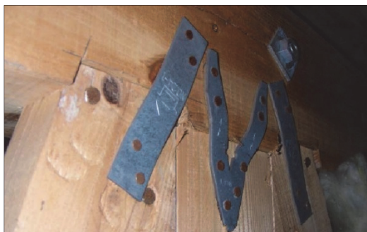
接合金物の様子（山形プレート・平金物）
